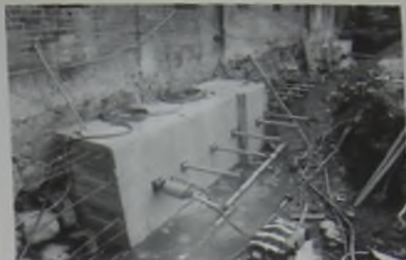
Abb. 4 Die Westwand des Mittelschlusses 1993, in der Zeit des Einbaus der neuen Sicherungsmitteln. Fot. L. Olawski
