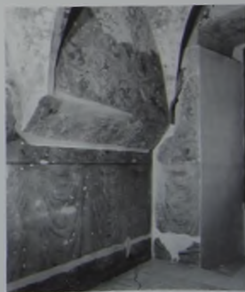
Abb. 6 Die „Hochmeisterstube“ (Bod.) auf dem Hauptgeschoss des Palastbaus, die Mauer des westlichen Risalits vor von 1393, mit einem Riß in der Ecke (nach links) abgesondert, zu der Räumlichkeit von 1390 angepaßt. Restaurierungszustand 1993. Fot. L. Olawski
