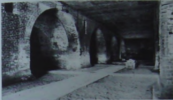
Abb. 14. Das Mittelschiff während der Auswertung und Restaurierung, Zustand im Jahr 1990. Foto L. Okoński.
