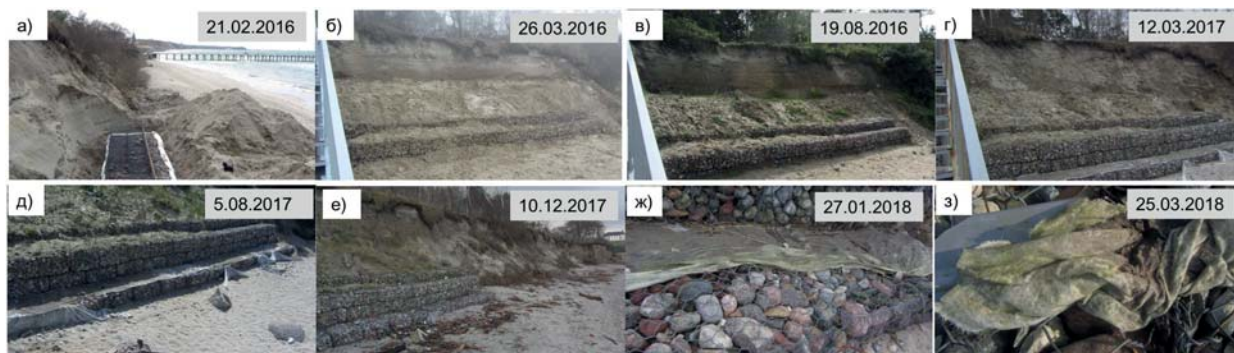
Рис. 6. Геосинтетические материалы на берегах у пос. Заостровье: а–ж) виды габионной конструкции в течение 2 лет с момента строительства, ж–з) геотекстиль в основании габиона со следами старения / биообрастания (фото Есюковой Е. Е.).
